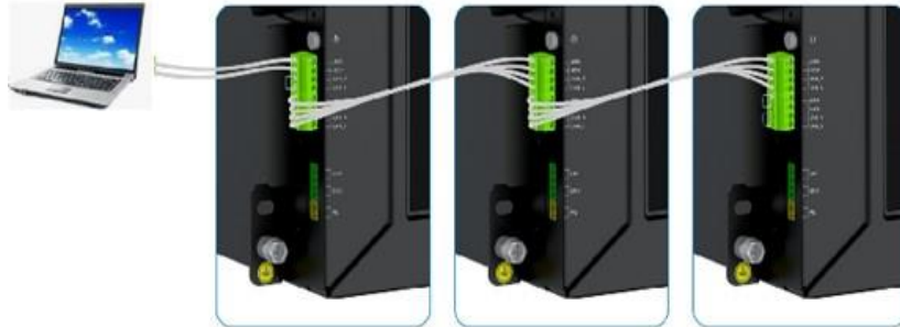
Şekil 44 3 adet parallel bağlı Lityum Akünün haberleşme kablolarının bağlanması
