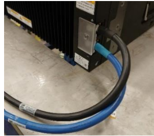
Şekil 7 Lityum Akü Güç Kablo Bağlantısı
