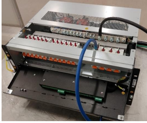
Şekil 3 Güç Kaynağı-Akü Güç Bağlantı Kabloları
