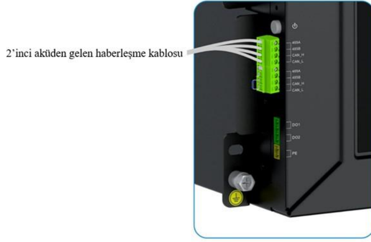
Şekil 47 3'üncü(son) Lityum akü için haberleşme bağlantıları ve eşleştirme direnci bağlantısı
