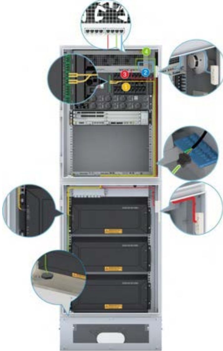
Şekil 16-30 VC9910A + PC9910A-Li Kabinetlerinin Kombinasyonunda Kablo Bağlantıları (2)
