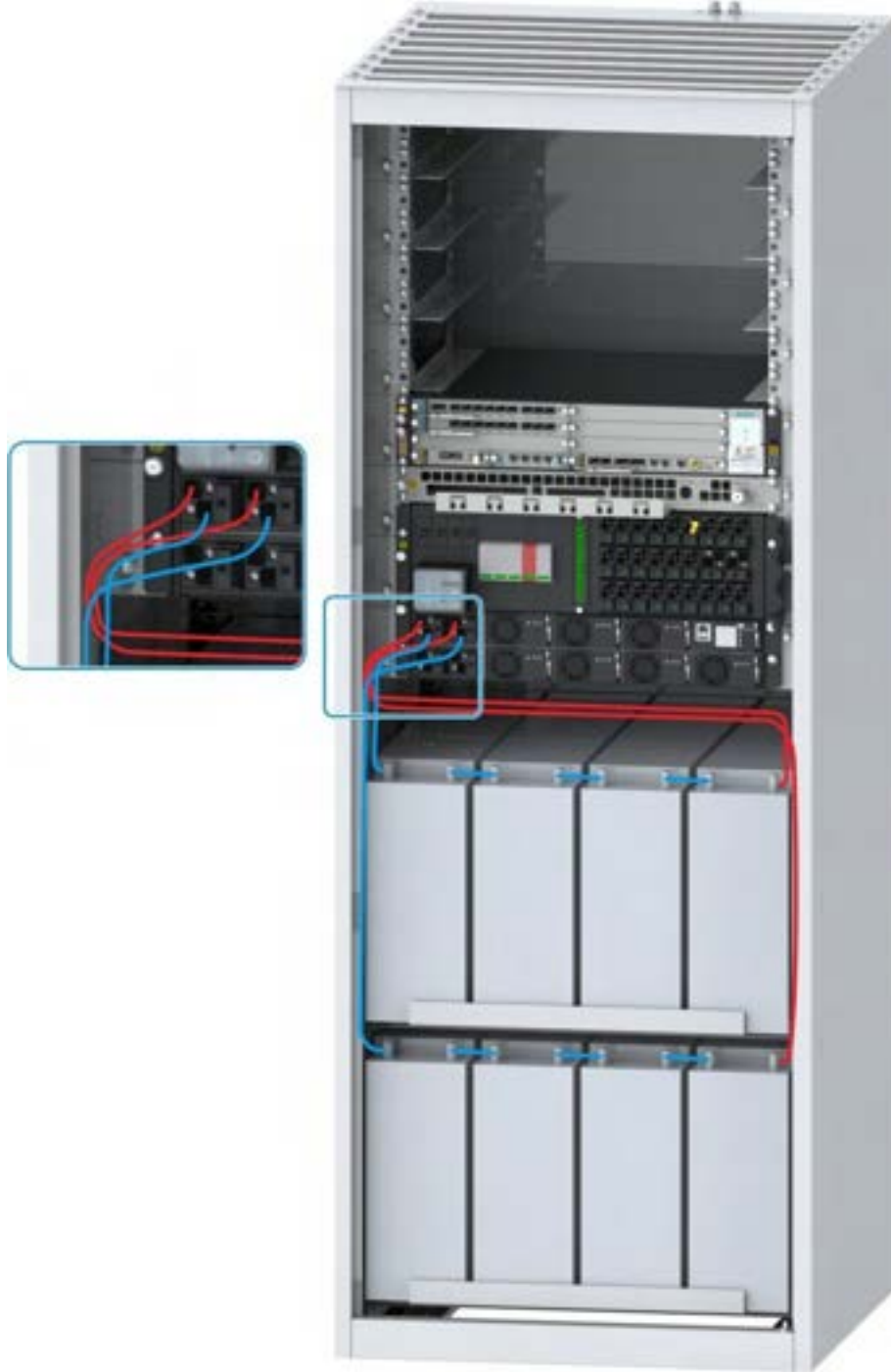
Şekil 14-24 VC9812 Kabinetinde Akü Güç Kablolarının Yönlendirilmesi
