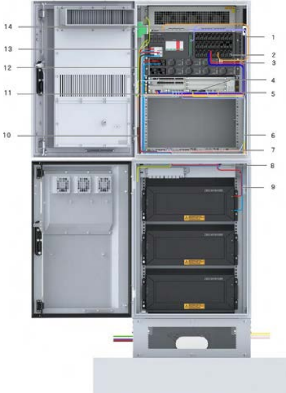
Şekil 16-29 VC9910A + PC9910A-Li Kabinetlerinin Kombinasyonunda Kablo Bağlantıları (1)
