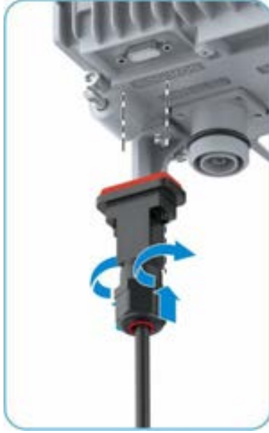
Şekil 11-6 AISG Kablosunun ZXSDR R8892N'ye Bağlanması
